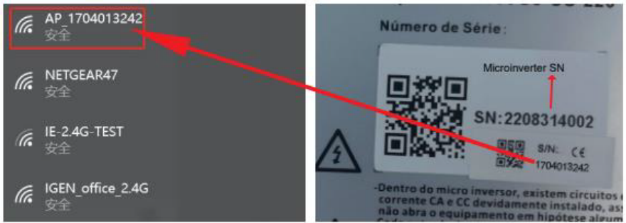
Mikrowechselrichter-SN: 2208314002; Eingebauter Datenlogger:1704013242
